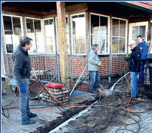
Oldies bei der Verlegung von Kabeln zur neuen Anzeigetafel unter der Anleitung des ausgebildeten Fachmannes „Hammi“ Hamann (ganz rechts, hinten).
